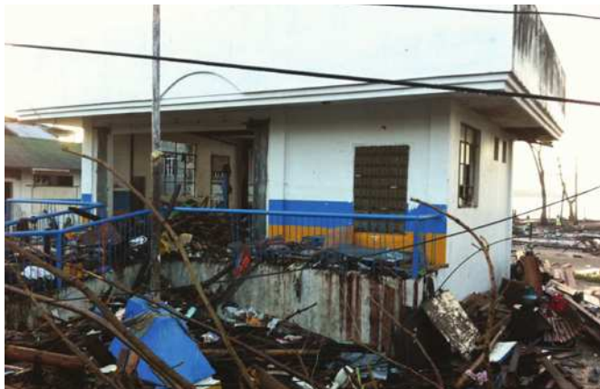
Здание почты в г. Таклобан (Филиппины) было разрушено тайфуном Хайан в ноябре 2013 г. и потребовало полной реконструкции.
