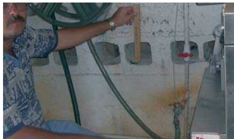
Нагон высотой один метр обрушился на это помещение, где располагается водородный генератор (помещение находится на высоте 1,8 м)
