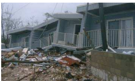
Полное разрушение жилого комплекса
