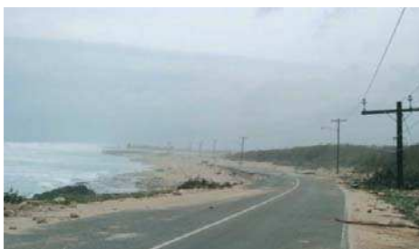
Волновая эрозия прибрежной дороги
