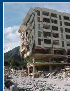
Разрушающиеся здания представляют собой опасность в период после бедствия
