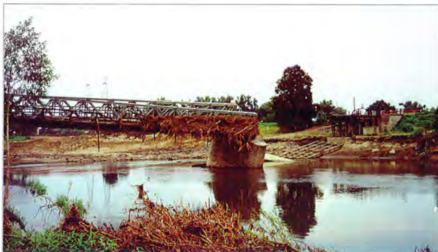
Мост через реку Верхняя Одра разрушен в результате наводнения в июле 1997 г. (Институт метеорологии и управления водными ресурсами, Польша)
