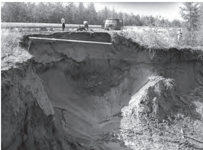
Рис. 2. Надземный трубопровод в Якутии, проложенный по территории с реликтовыми мощными повторно-жильными льдами. Фото А.Н. Федорова, Институт мерзлотоведения (Станиславская, Мерзляков, 2013).
