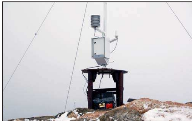
Крепление мачты и размещение аккумуляторов питания
