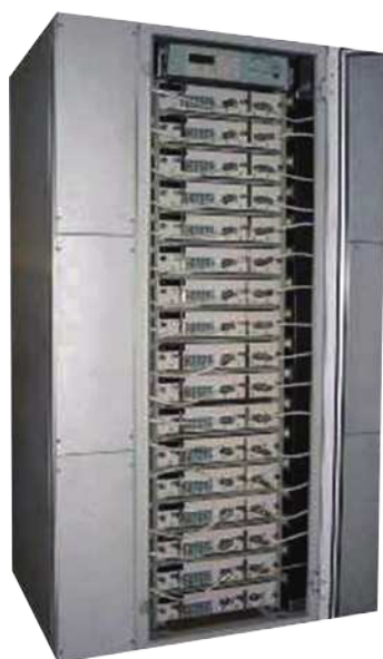
Шкаф транзисторного передатчика
