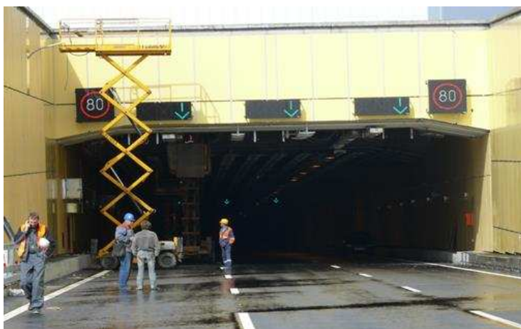
Рисунок 42 – ЗПИ на автодорожном тоннеле судопропускного сооружения С-1 КЗС
