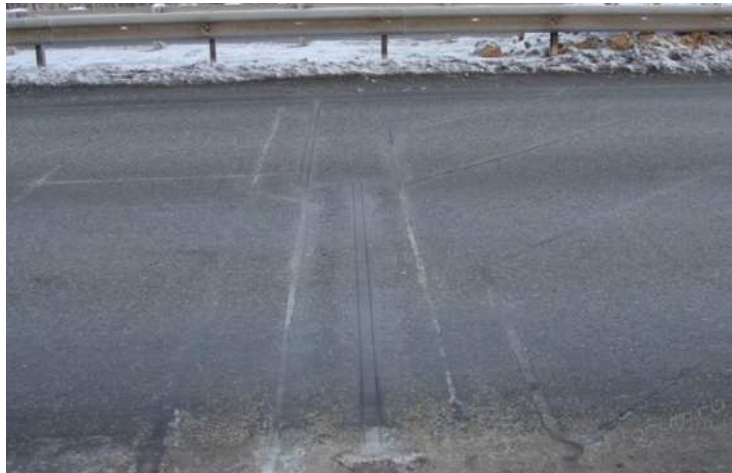
Рисунок 63 – Пример смонтированного WIM-сенсора
