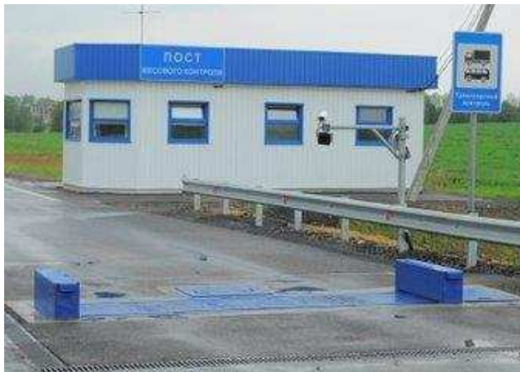
Рисунок 61 – Стационарный пункт весогабаритного контроля (около поселка Лесково на 14 км трассы А-114 Вологда – Тихвин. Автомобильная дорога Р-21 «Кола»)
