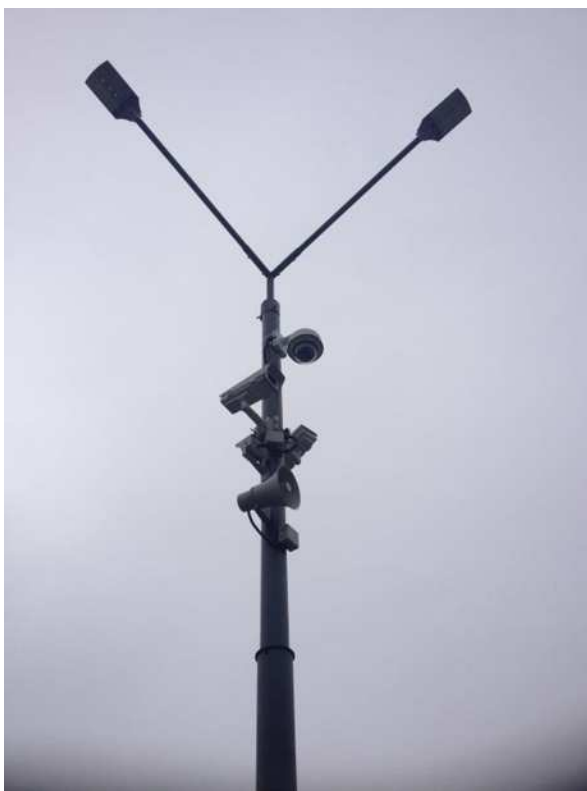
Рисунок 34 – Пример установки видеокамер на опоре освещения
