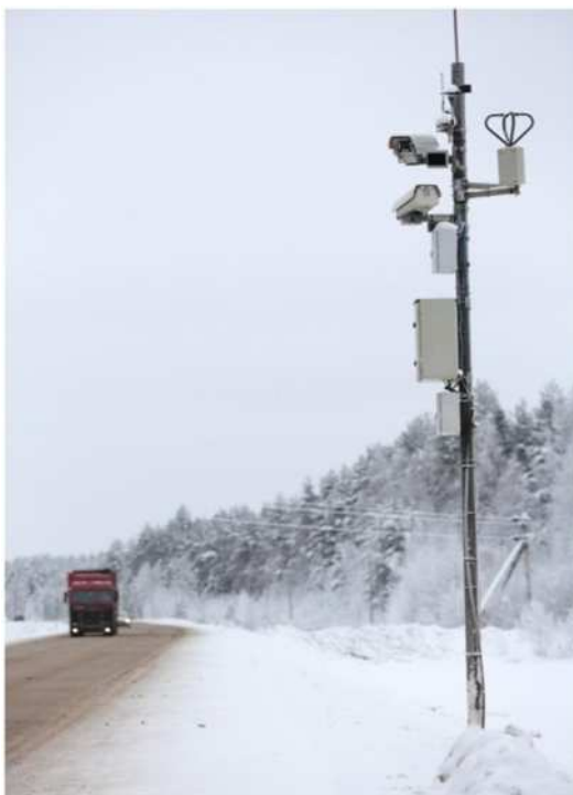
Рисунок 89 – Пример установки системы дорожного мониторинга «Кондор» (производство ЗАО «МИНИМАКС-94»)
