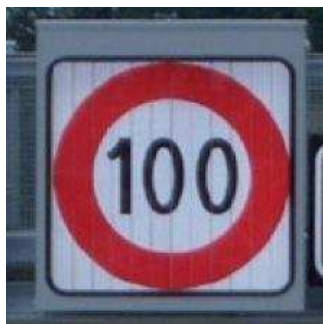
Рисунок 44 – Пример электромеханического дорожного знака переменной информации
