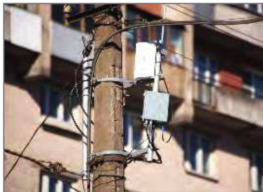
Рис. 67. Пример установки стационарного модуля DSRC на УДС Санкт-Петербурга
