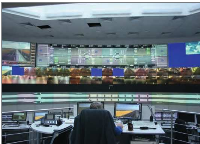
Рис. 9. Операционный зал Центрального диспетчерского пункта тоннеля
