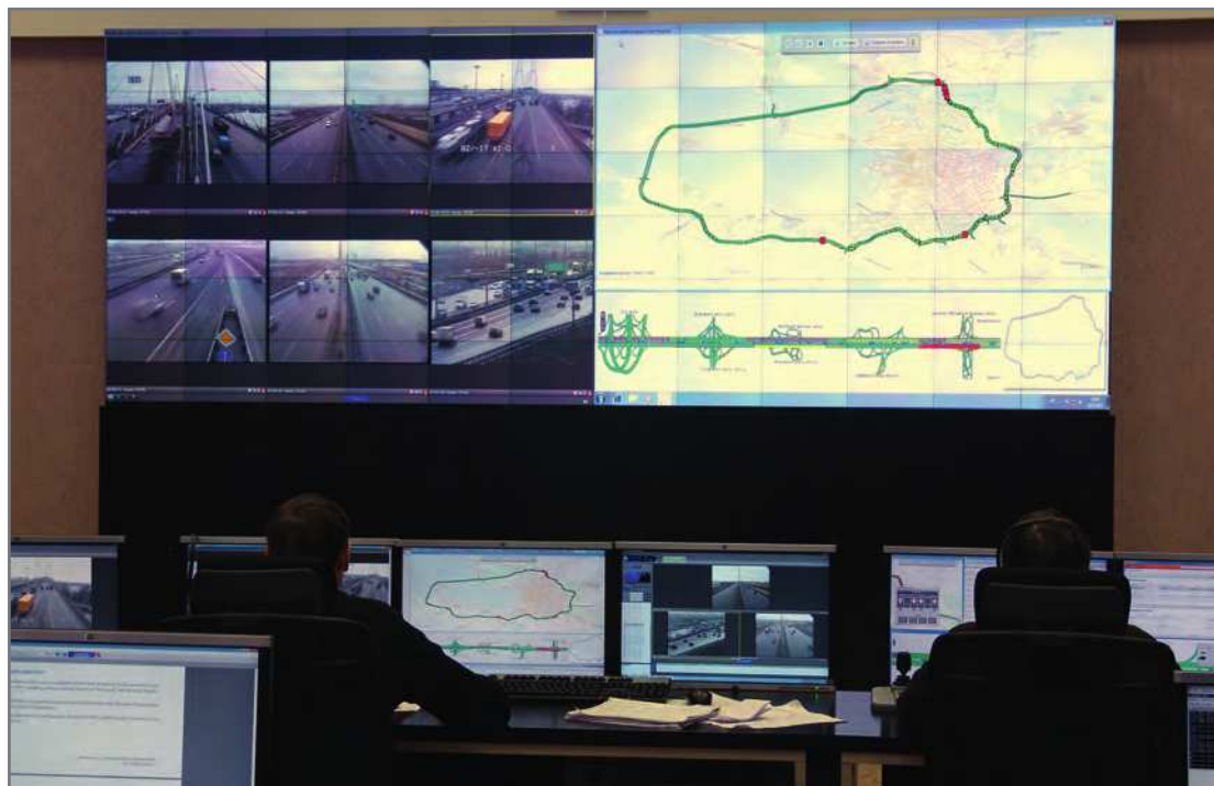
Рис. 6. Диспетчерский зал Центрального пункта управления КАД
