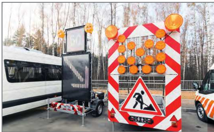
Рис. 38. Внешний вид мобильных комплексов, применяемых для информирования участников дорожного движения на федеральной автомобильной дороге М-1 «Беларусь» (Обход г. Одинцово)
