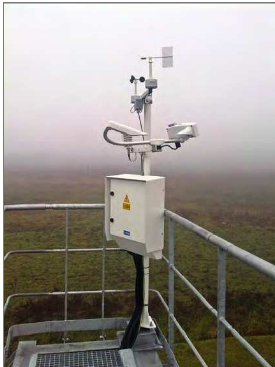
Рис. 4. Дорожная метеорологическая станция, установленная на КАД
